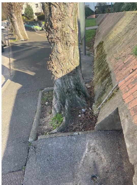
b) Vue du défaut
